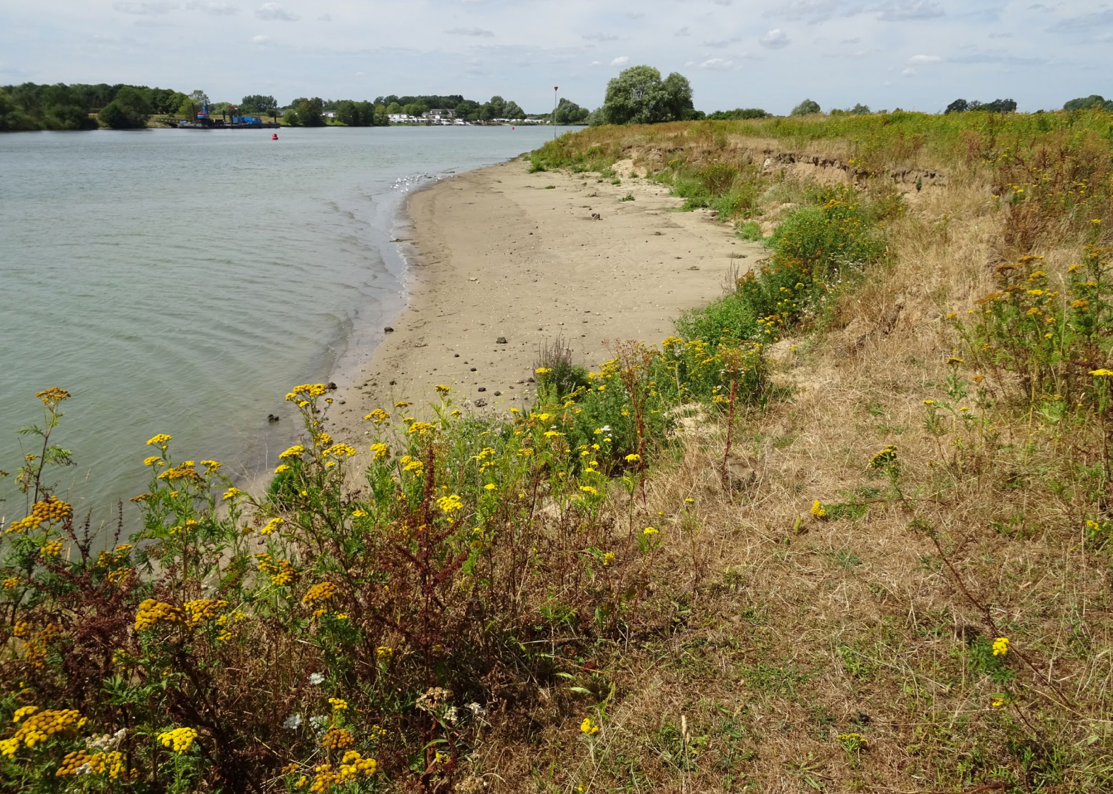
Ontsteende Maasoever Wellerlooi Foto: Rijkswaterstaat
